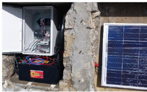
Photo de l'installation
