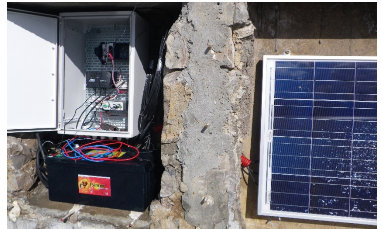
Photo de l'installation
